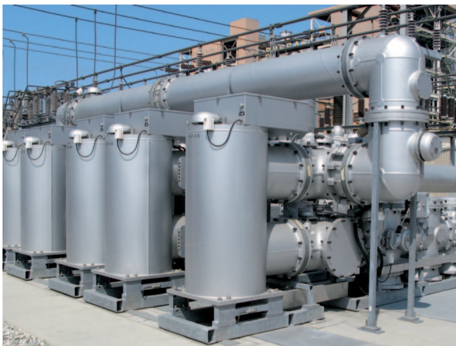
Fig. 2 SF 6 -GIS, ELK-04, 170 kV (ABB, Germany)
