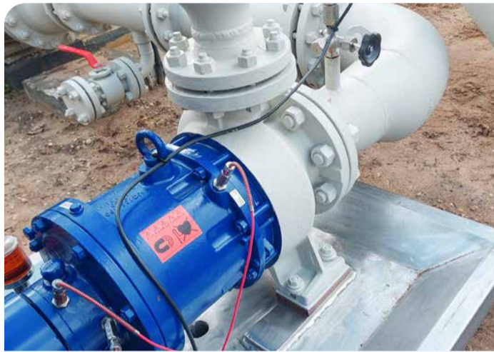
Mit der neuen Pumpstation in Rhede senkt die SGW den Stromverbrauch um rund 20.000 Kilowattstunden pro Jahr.
